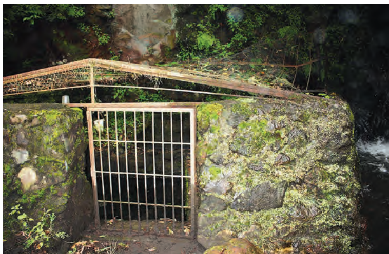
Foto 109. Caja de captación de agua en lecho del río Amatzinac. Tetela del Volcán, Tetela del Volcán. 2011.
